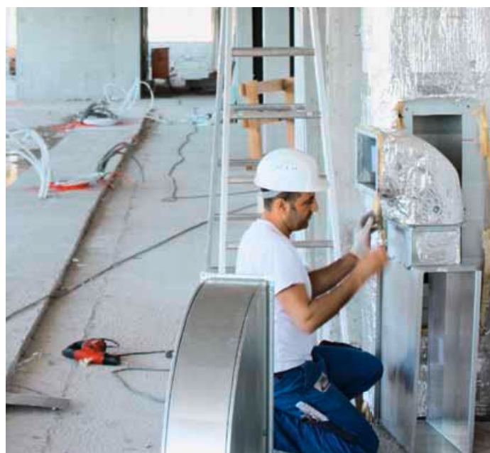
Zehn einzelne Anlagen bilden die lufttechnische Anlage im neuen Energiedienst-Bürohaus.
